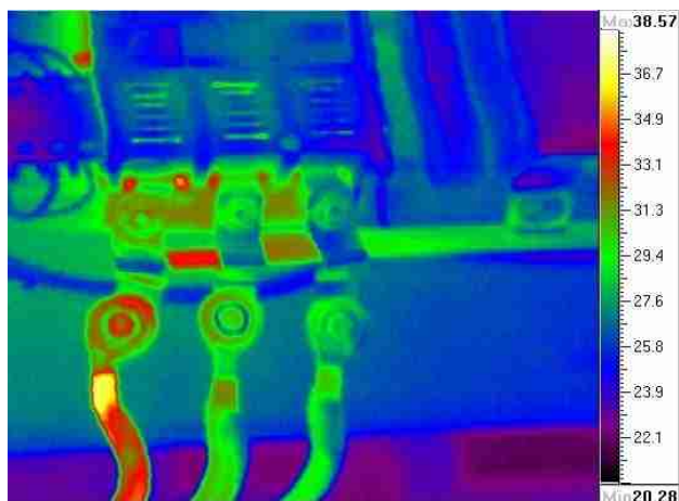
Рисунок 21. Пример термограммы контактных соединений с температурной шкалой
