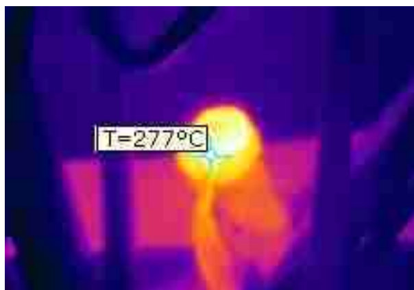
Рисунок 22. Пример обнаружения пожароопасного разогрева болтового контактного соединения
